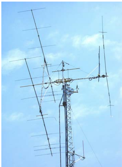
Figura 5: Pluma de 10,7 m de JE1BMJ, yagis de 18 elementos apilados a 7,7 m de distancia con un mecanismo de rotación de elevación.
